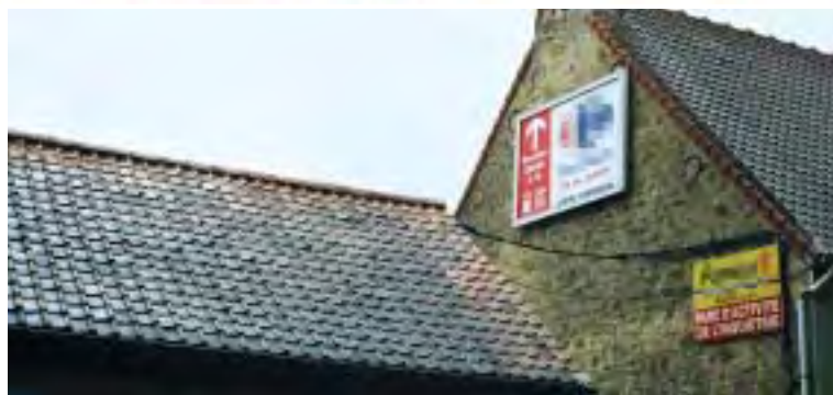
Constat : panneaux de 2m 2 et 1,5m 2 - interdits en PNR.
