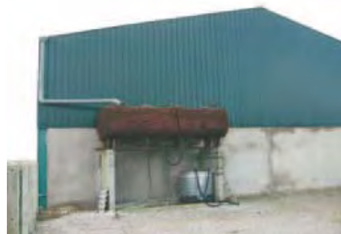
Exemple d'un système de récupération des eaux pluviales
